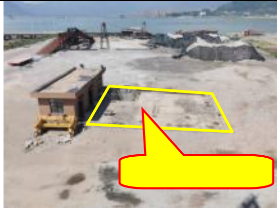
生活污水及含尘废水地理式污水处理站
