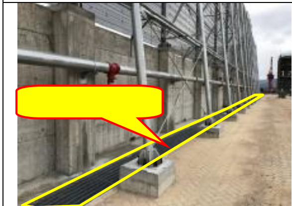
堆场旁初期雨污水收集沟
