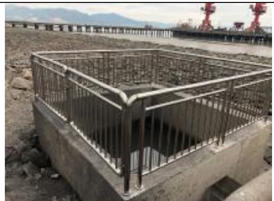
栈桥边初期雨污水收集池
