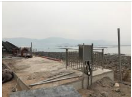
陆域后方初期雨污水收集池
